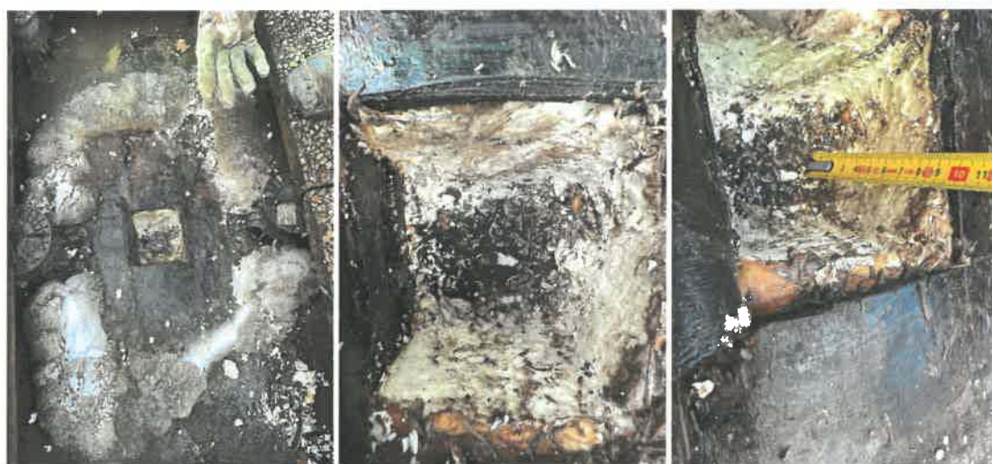
Réalisation d'un sondage, Isolation thermique en panneaux de mousses de polyuréthane de 80mm imbibé d'eau .
