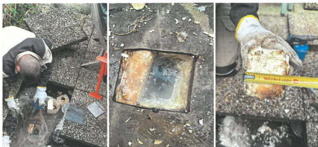
Réalisation d'un sondage, Isolation thermique en panneaux de mousses de polyuréthane de 80mm gorgée d'eau .
