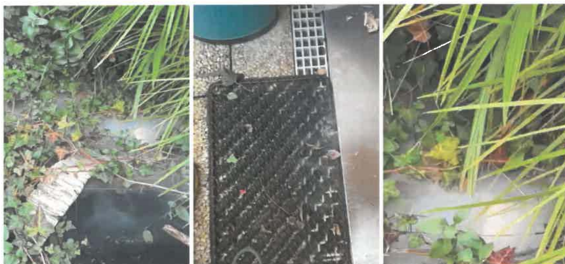
Réalisation d'un test fumigène. Apparition de la fumée blanche au droit des relevés et de la jardinière.
